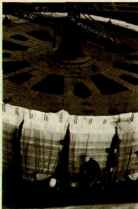
Fig. 2. SALTO GRANDE. La turbina requiere compleja instalación.
